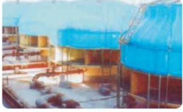
Su Soğutma Kulesi
